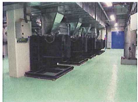
Salles de filtration
